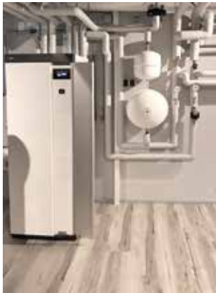
Der Heizungstausch mit einer NIBE Wärmepumpe. Foto: NIBE Systemtechnik/akz-o
